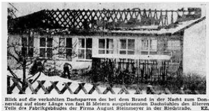
Brand im Jahr 1957. Hier ging auch das Firmenarchiv in Flammen auf.
